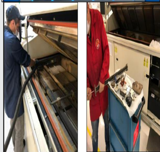
Limpeza do Cooler de Ventilação
