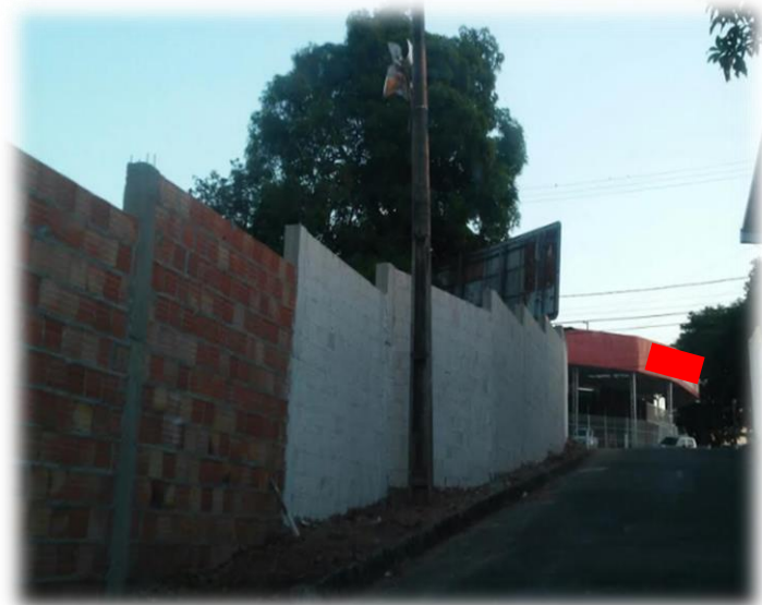
Figura 26 - Foto da Rua Monteiro.
