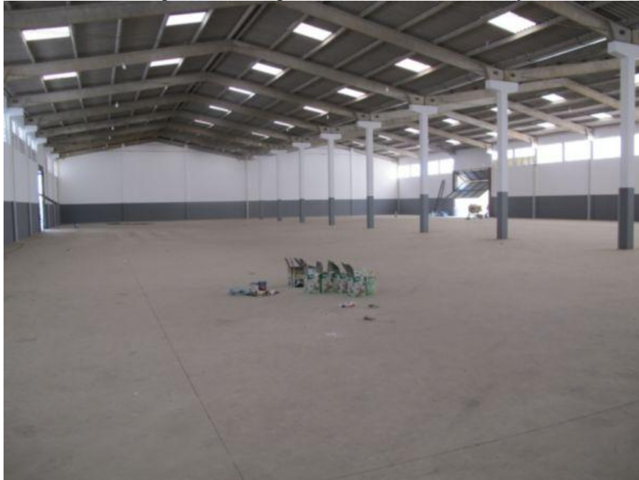
Figura 6 - Projeto de iluminação de um galpão fabril, onde se visualiza o uso de telhas acrílicas transparentes, para aproveitar a luz natural e pintura neutra, para o conforto visual na execução das futuras atividades.
