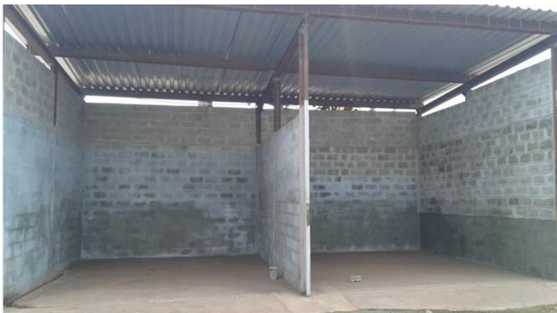
Figura 4.8 - EPÓSITO INTERMEDIÁRIO DE RESÍDUOS (DIR) construída para resíduos de grãos (1 (uma) baía para subproduto a ser destinado para aterro e outra baía para produto a ser destinado para venda (compostagem/blendagem)).
