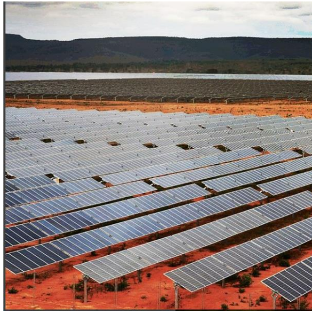
Figura 2.17 - Usina de Energia Solar em Pirapora. Fonte: SOLENERG (2017).
