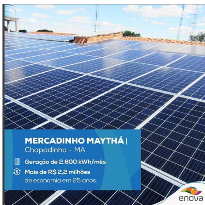
Figura 2.16 - Mercadinho Maythá e seu telhado com painéis fotovoltaicos para geração de eletricidade. Fonte: ENOVA (2018).
