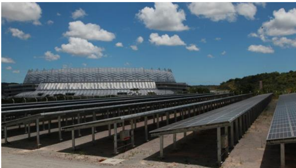
Figura 2.22 - Usina solar em Pernambuco. Fonte: ENOVA (2018).
