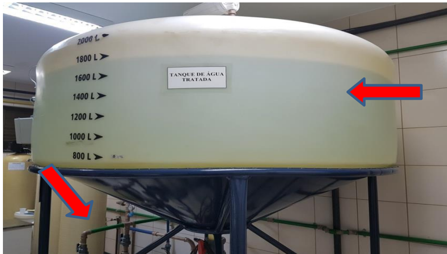
Figura 2.3 - Tanque de água tratada
