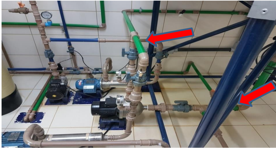
Figura 2.2 - Tubulação do sistema de tratamento da água
