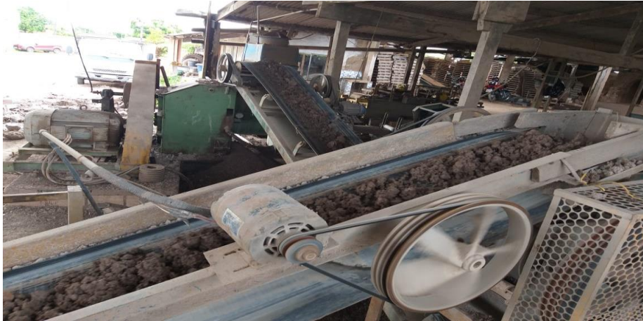
Figura 4.17 - Fiações dos motores expostas.
