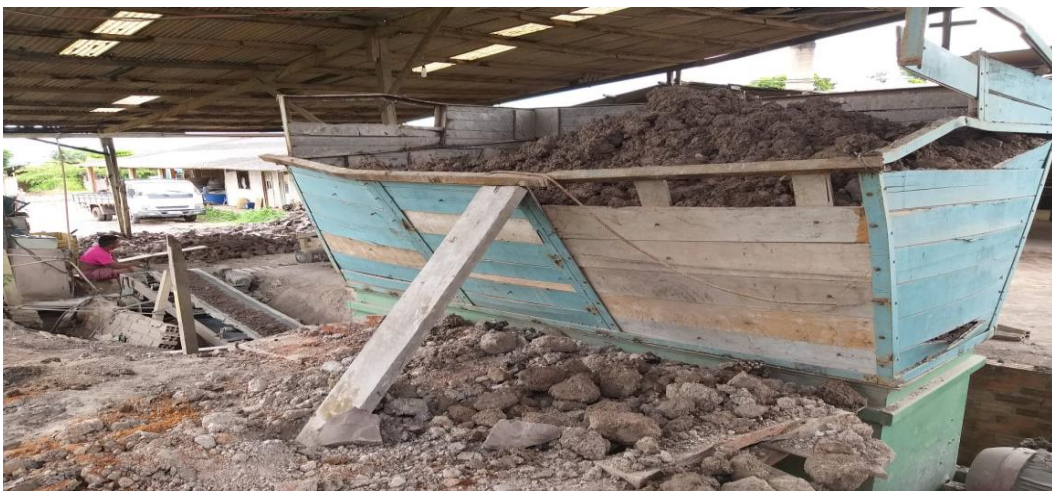
Figura 4.3 - Caixão de alimentação.
